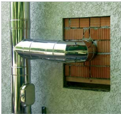
Wanddurchführung in herkömmlicher und aufwändiger Bauweise.
